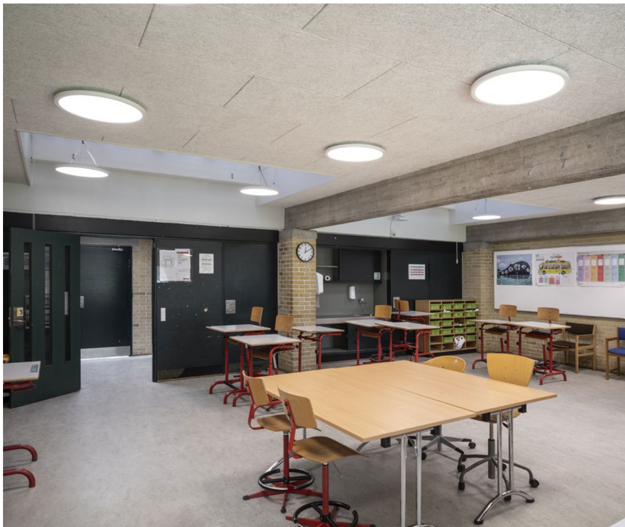
Klasseværelse på Ellehøjskolen efter renovering, monteret med Troldekt® Ventilationplader.
